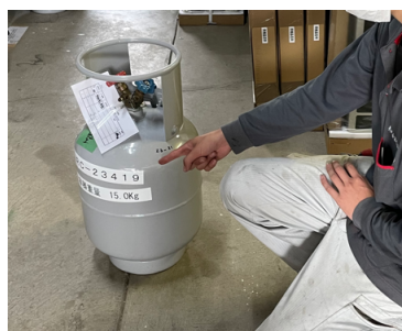
フロンボンベの使用期限確認 全て期限内 OK
