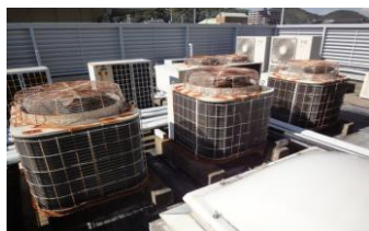
冷媒配管にピンホールが発生している...
