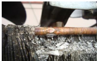
冷媒配管がむき出しな箇所がある...
